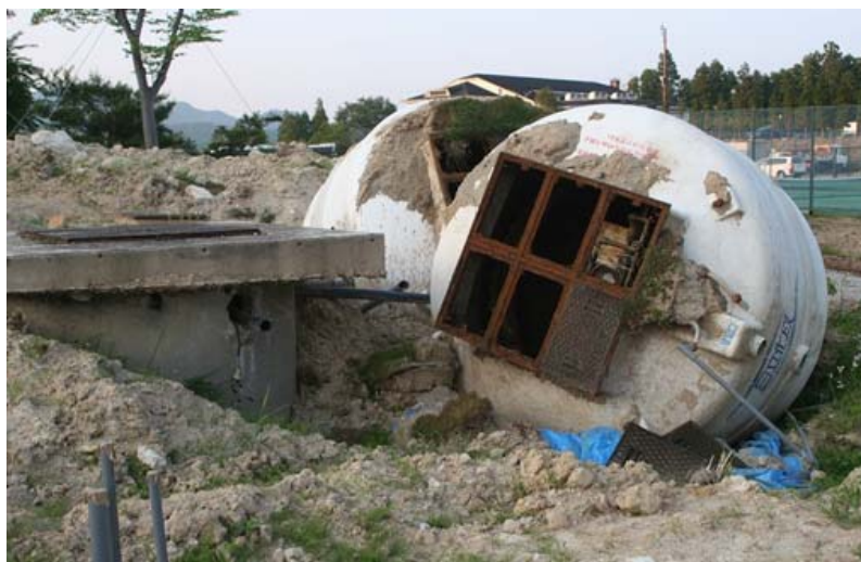
写真 3.2.10 法面崩壊による沈殿槽の浮上り転倒
