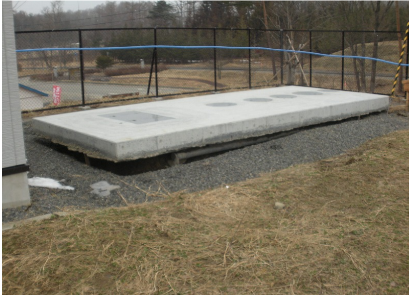
写真 3.2.11 浄化槽周辺の地盤沈下
