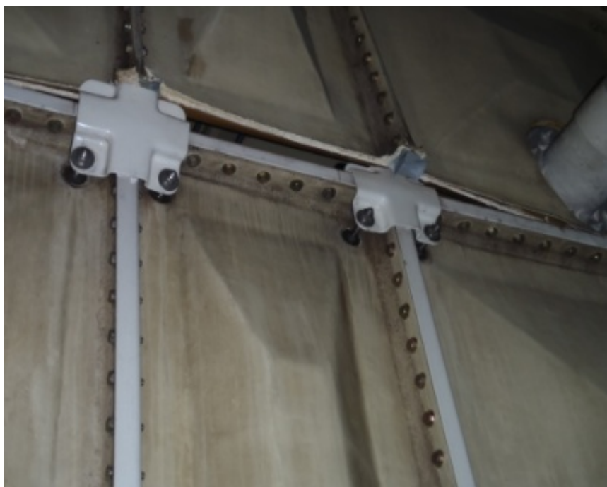
写真 3.2.2 FRP 製受水槽のパネルの損傷
