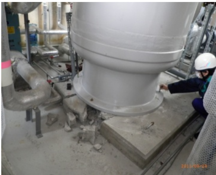
写真 3.2.16 砂式ろ過器への変更に伴い基礎を大きくした部分の損傷
