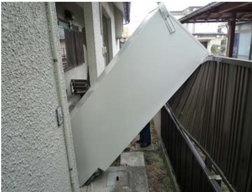
写真 2.2.5 家庭用ヒートポンプ給湯機用タンクの転倒
