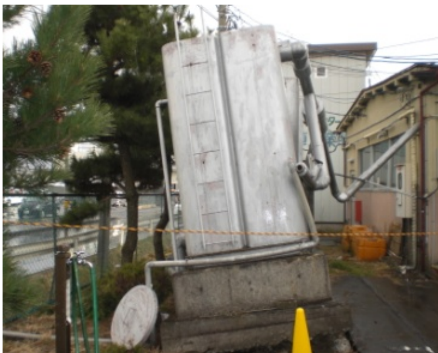
写真 3.2.1 地盤隆起による受水槽の傾斜
