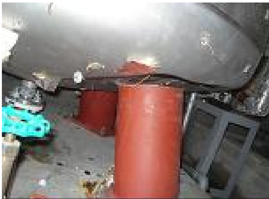
写真 3.2.7 縦型貯湯槽脚部の本体へのめり込み
