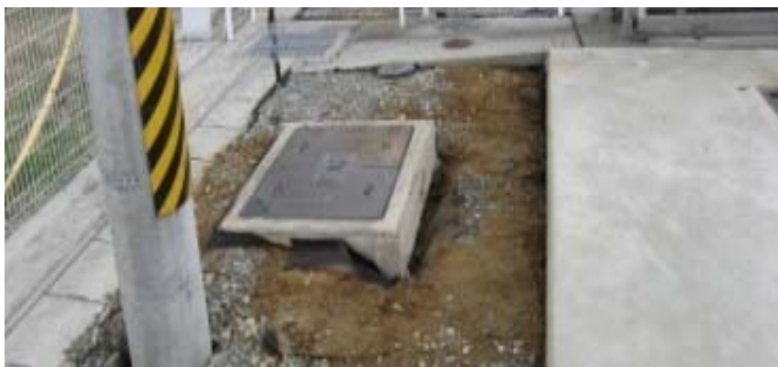
写真 3.2.3 量水器ボックス周辺の給水管の破損
