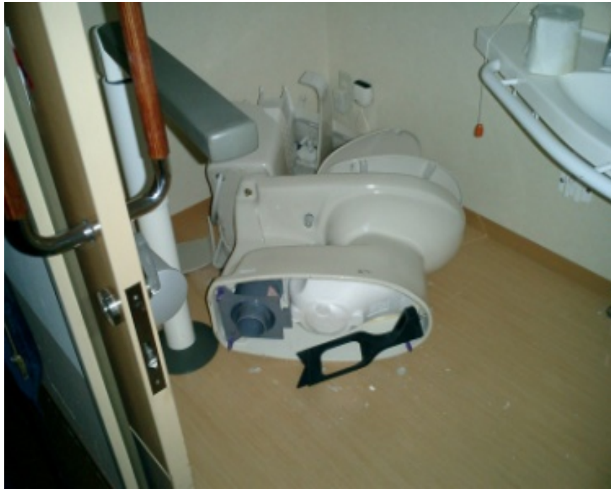
写真 3. 2. 13 洋式便器の転倒
