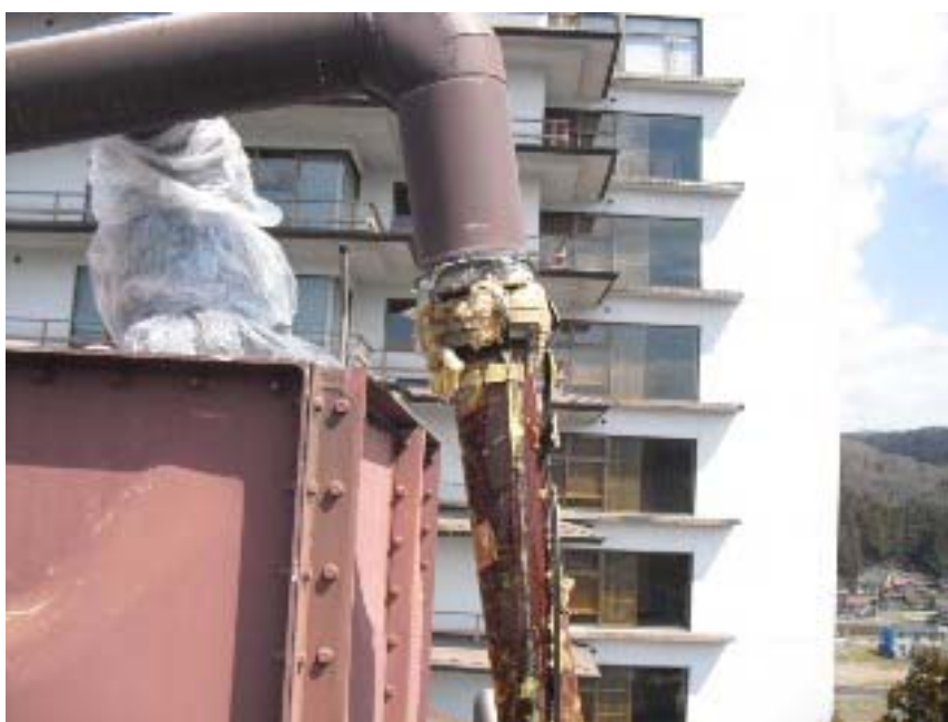
写真 3.2.4 高置水槽周辺の揚水管継手部の破損
