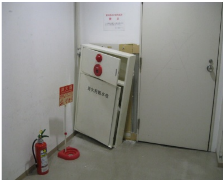
写真 3. 2. 14 消火用補助散水栓箱の脱落
