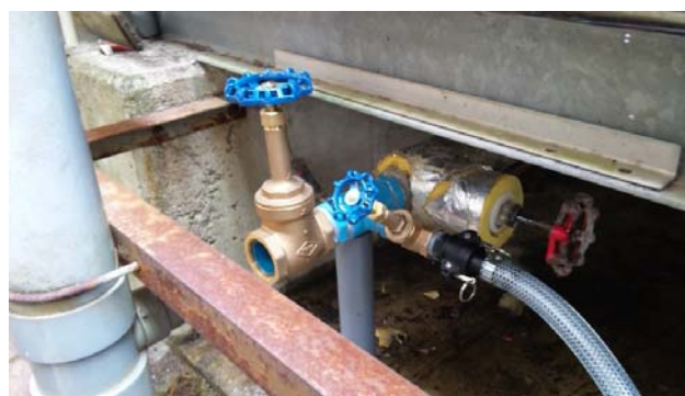
写真 5.2.6 給水栓ユニット・受水槽接続部
