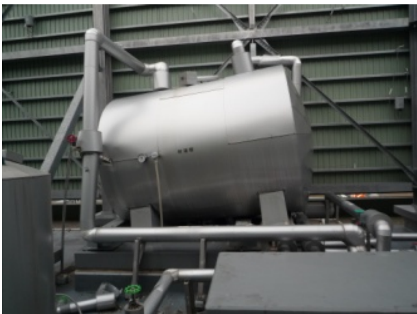
写真 3.2.8 横型貯湯槽脚部の座屈による傾斜
