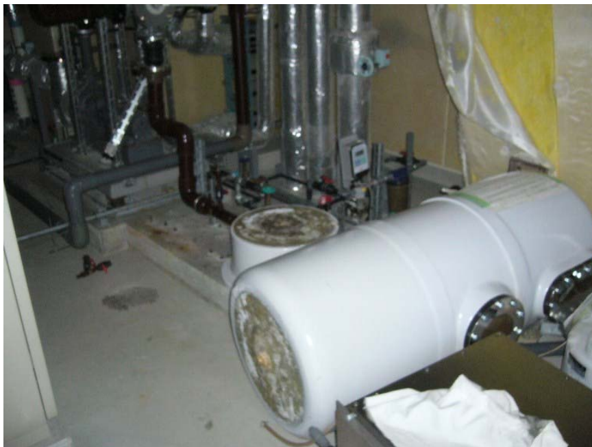
写真 3.2.15 砂式ろ過器の脚部と本体との分離
