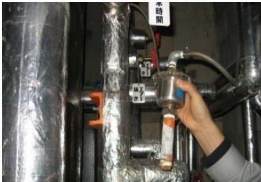
写真 3.2.9 給湯用エア抜き弁下部配管の損傷
